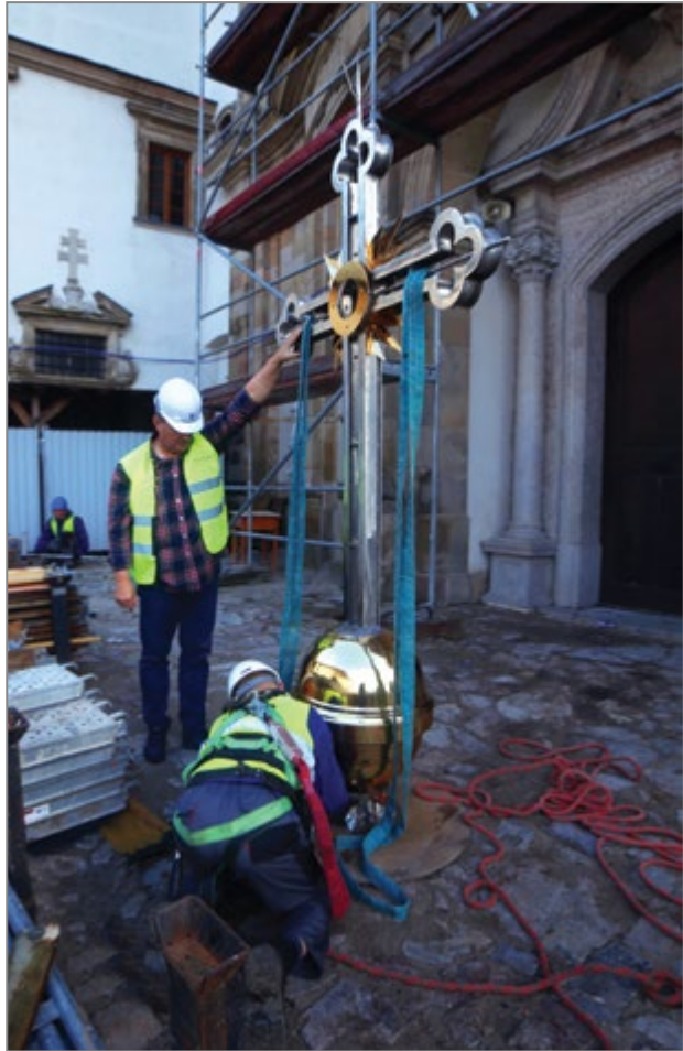
40. Przygotowanie krzyża do montażu nadzoruje Krzysztof Furmanek, 2014 r. Źródło: archiwum spółki Furmanek Renewal.
