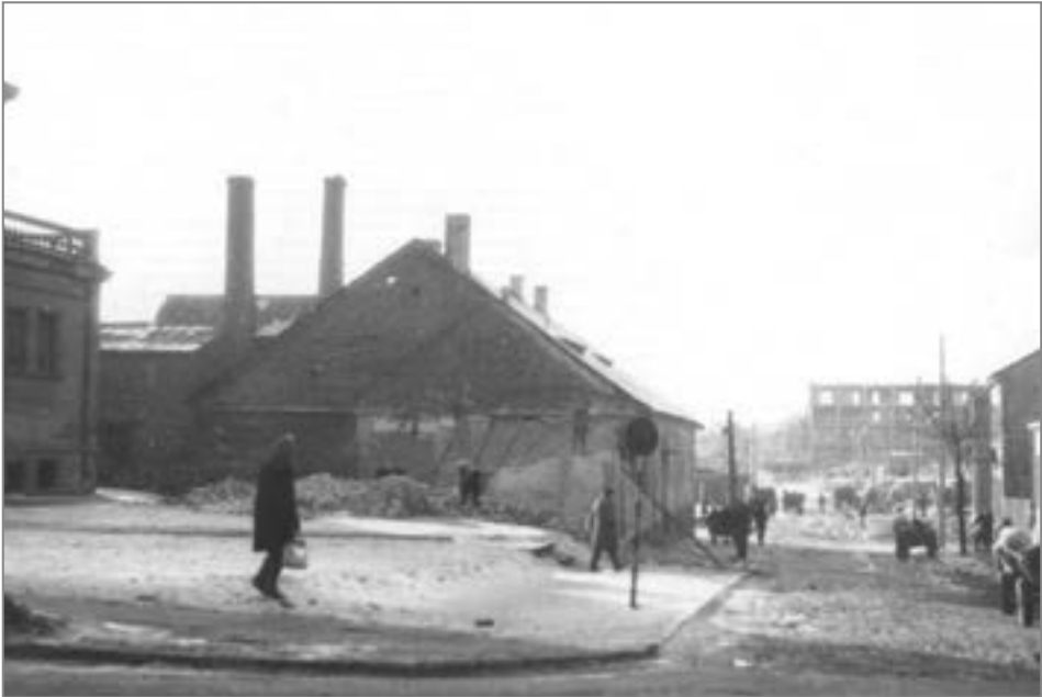
16. Początek rozbiórki budynku łaźni, widok od strony ul. Warszawskiej, w oddali rozpoczęta budowa gmachu Urzędu Wojewódzkiego, 1968 r. Źródło: zbiory autora.
