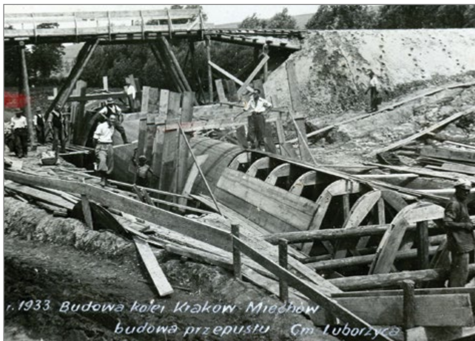
12. Budowa kolei Kraków – Miechów; budowa przepustu w gminie Luborzycza, 1933 r. Źródło: MHKi/H/2345.
