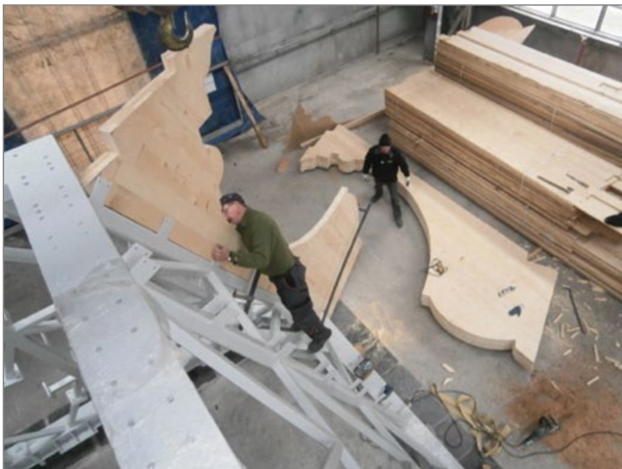
21. Mocowanie krążyn do segmentu S1 konstrukcji nośnej helmu wieży, 2014 r.; Źródło: archiwum firmy Burtan – Dachy.
