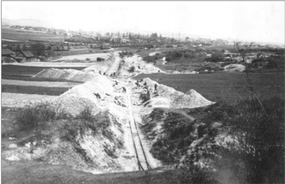
14. Kamieniołom Stanisława Konopki, ok. 1939 r., widok od zachodu. Źródło: zbiory Stanisława Konopki z Kielc.
