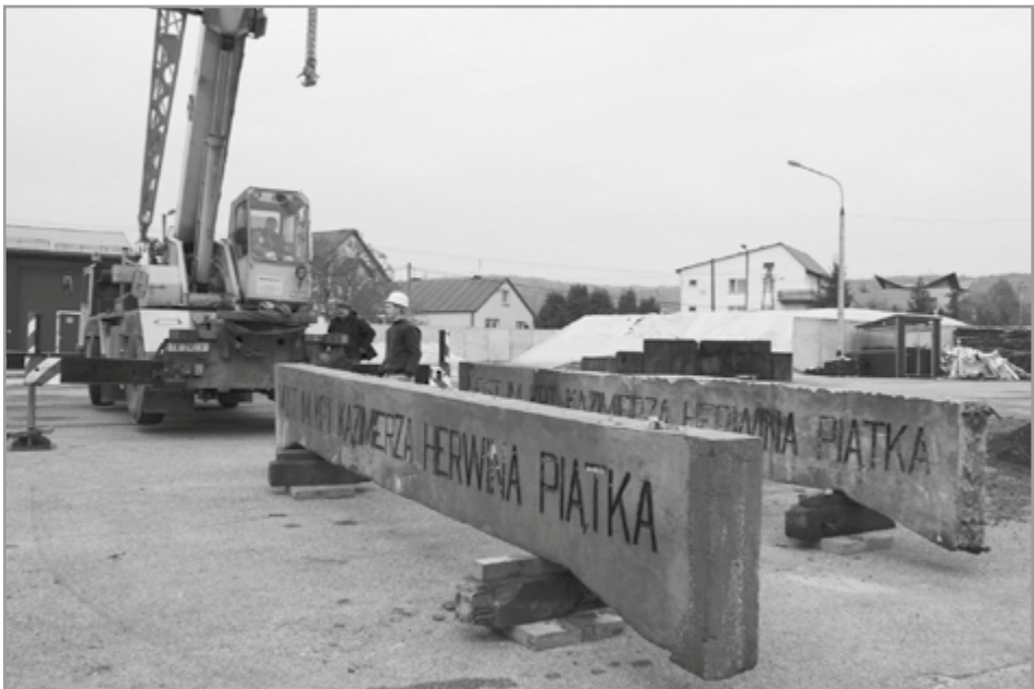
9. Skrajne tężniki mostu przechowywane w bazie Rejonu Dróg Wojewódzkich, oddział w Zgórsku, przygotowane do renowacji, 24.10.2016 r..
