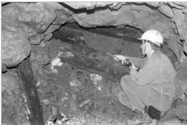
Ryc. 9. Pozostałości podziemnych wyrobisk kopalnianych prowadzonych na początku XIX w. i podczas I wojny światowej, odsłaniające się w latach osiemdziesiątych XX w. w zachodniej ścianie kamieniołomu dolomitów „Laskowa”; fot. Wojciech Szczygielski
